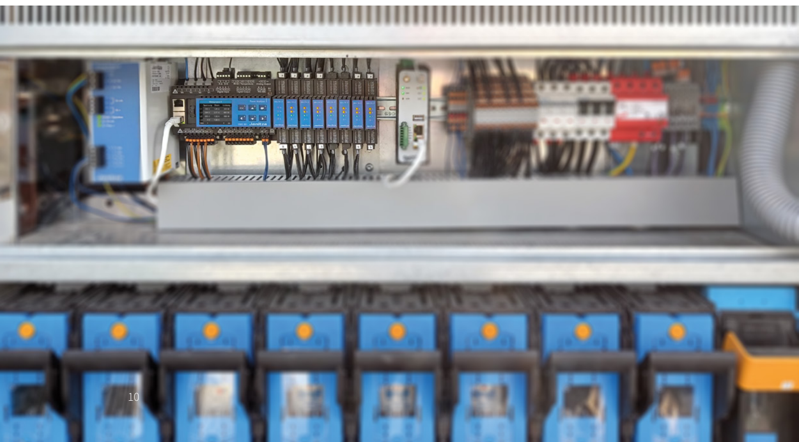
Das UMG 801 mit Modulen in einer Ortsnetzstation
