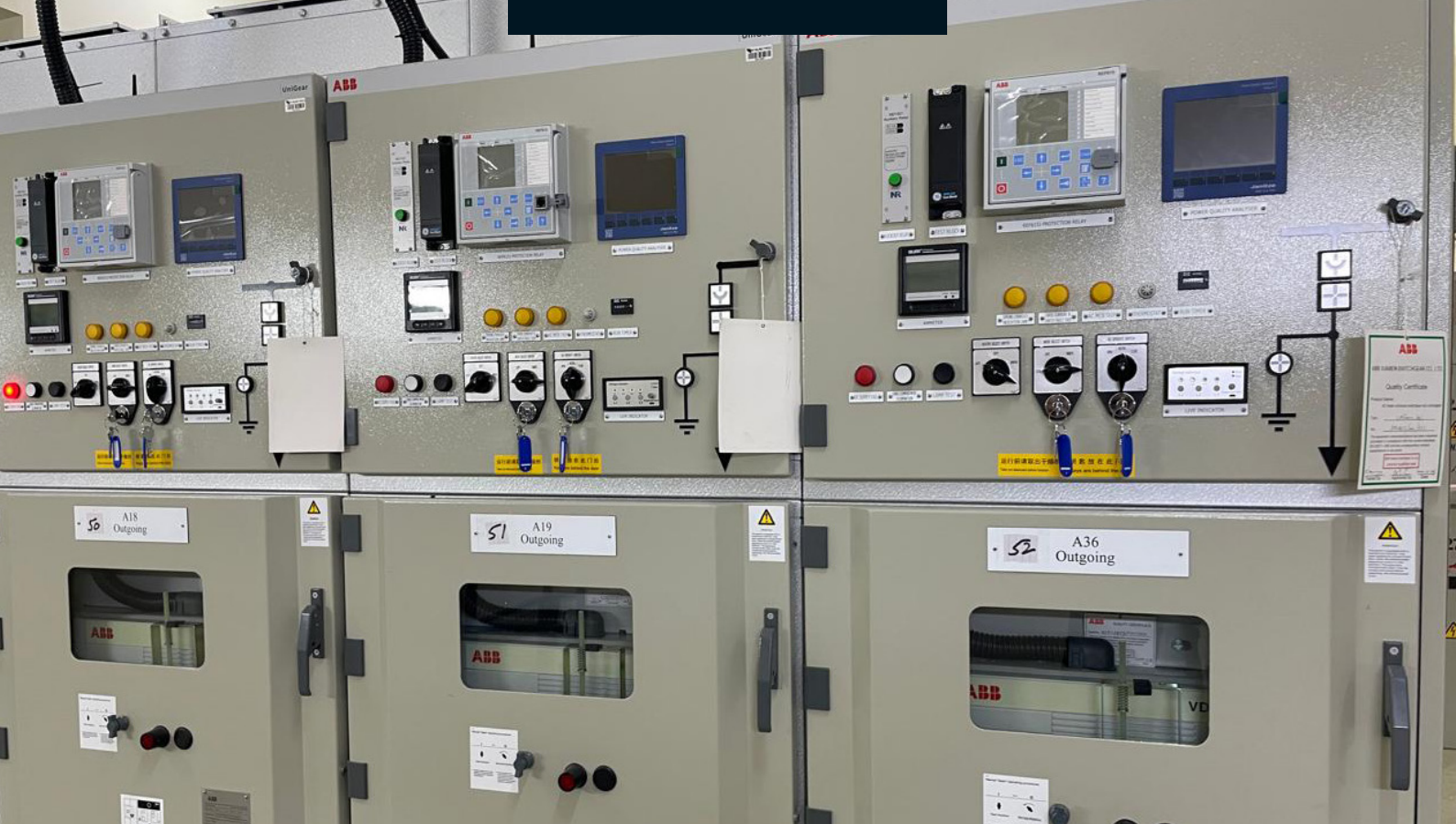
Versorgt Millionen Menschen mit Elektrizität: ein Teil der Janitza Lösung in der Detailansicht.
