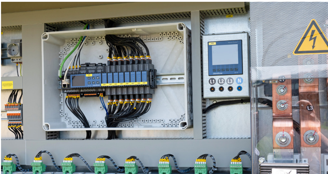
Ahorro de espacio: analizador de red UMG 801 con módulos de medición de corriente 800-CT8-LP y Remote Display RD 96 en una nueva estación
