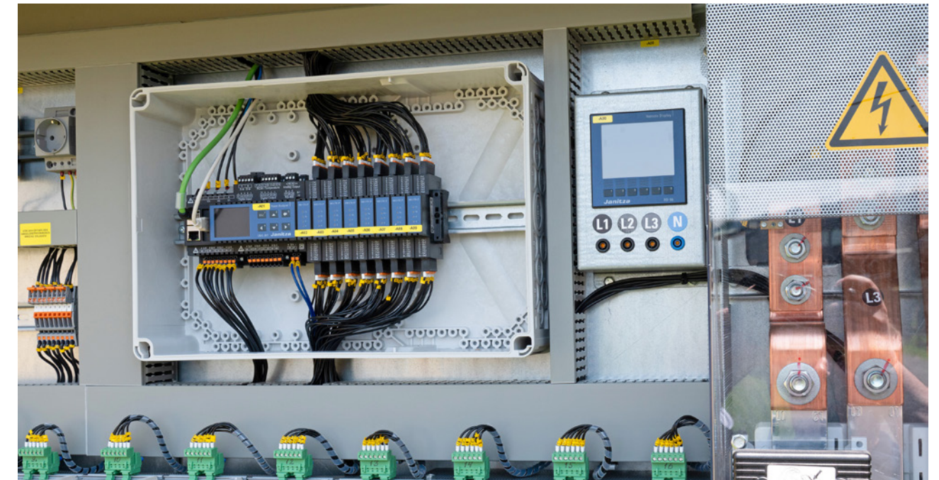
Platzsparend: Ein Netzanalysator UMG 801 mit Strommessmodulen 800-CT8-LP und Remote Display RD 96 in einer neuen Station
