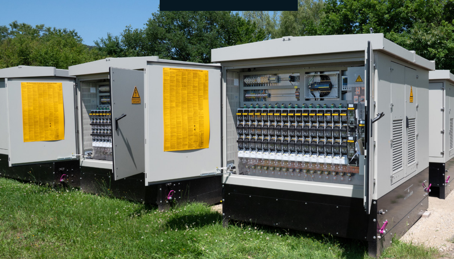
Neue Kompaktstationen warten auf ihren Einsatz. Sie sind bereits ab Werk mit der Messtechnik von Janitza ausgestattet
