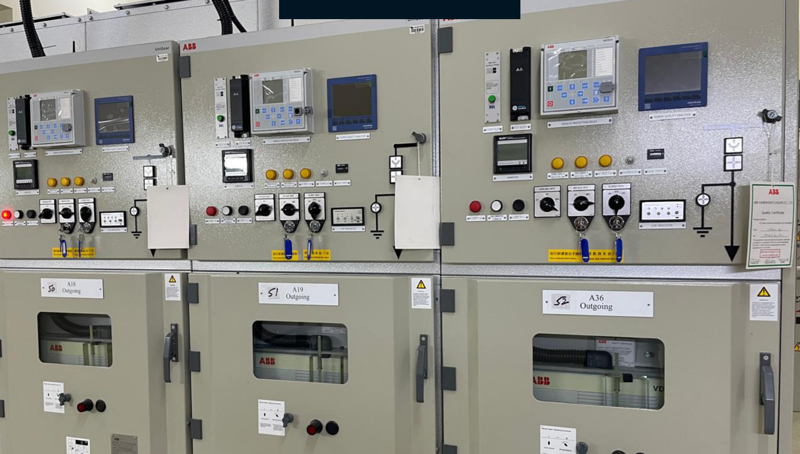
La solución suministra electricidad a millones de personas: parte de la solución Janitza en detalle.
